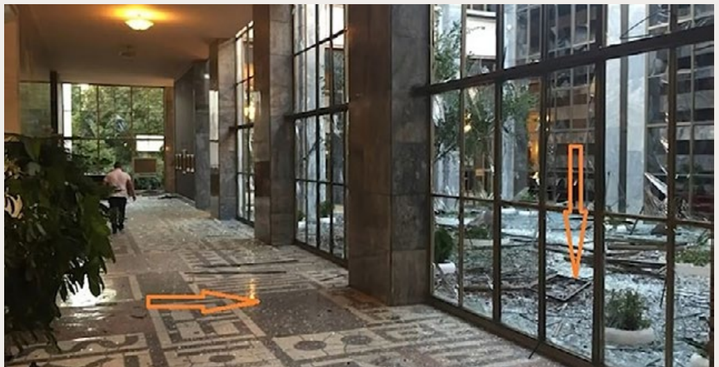
NOG MEER SCHADE IN HET PARLEMENT. HET GLAS LIJKT VOORNAMELIJK NAAR BUITEN TOE TE ZIJN GESPRONGEN. HOE KAN DAT ALS DE BOM VAN BUITEN IS GEBOMBARDEERD?, VRAGEN FATİH YILMAZ EN AHMET NESIN ZICH AF (BEELD: YOUTUBE / AHMET NESIN)
